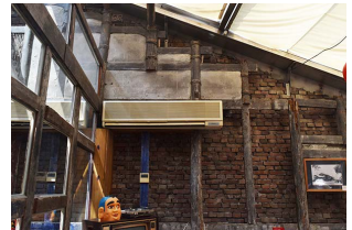
図10 延平路74号 76号の壁
