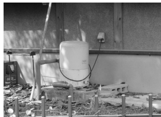
図 3 地下水揚水ポンプ
